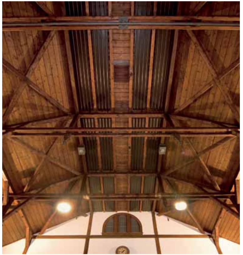
Die Platten wurden mit einer Gesamtlänge von beinahe 900 m teilweise auf 11,40 m Höhe unter dem Dach befestigt. Die kurzen Reaktionszeiten der Deckenstrahlplatten haben einen wichtigen Energie einsparenden Aspekt: Eine eventuell tagelang ungenutzte Halle muss somit nicht unnötig „durchgeheizt werden“.
