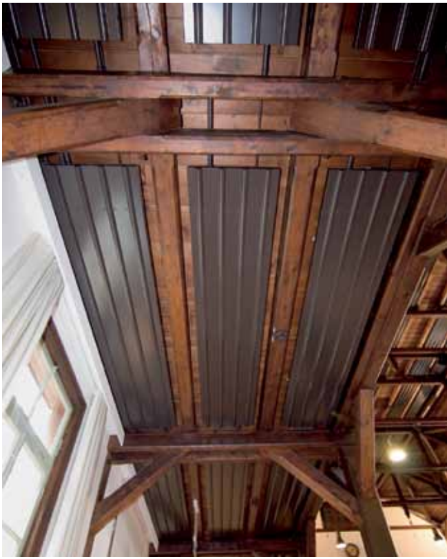
Das Heizsystem fügt sich gestalterisch ästhetisch in die Deckenstruktur ein: Die Strahlplatten wurden mit einem speziellen Farbton im Braun der Holzdecke lackiert und erhalten somit den ursprünglichen Charme des Ständerbau-Fachwerkhauses.
